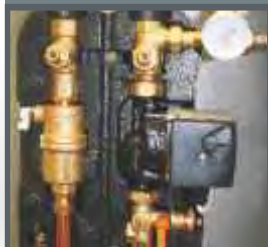
Plná výbava solární stanice s čerpadlem Grundfos
